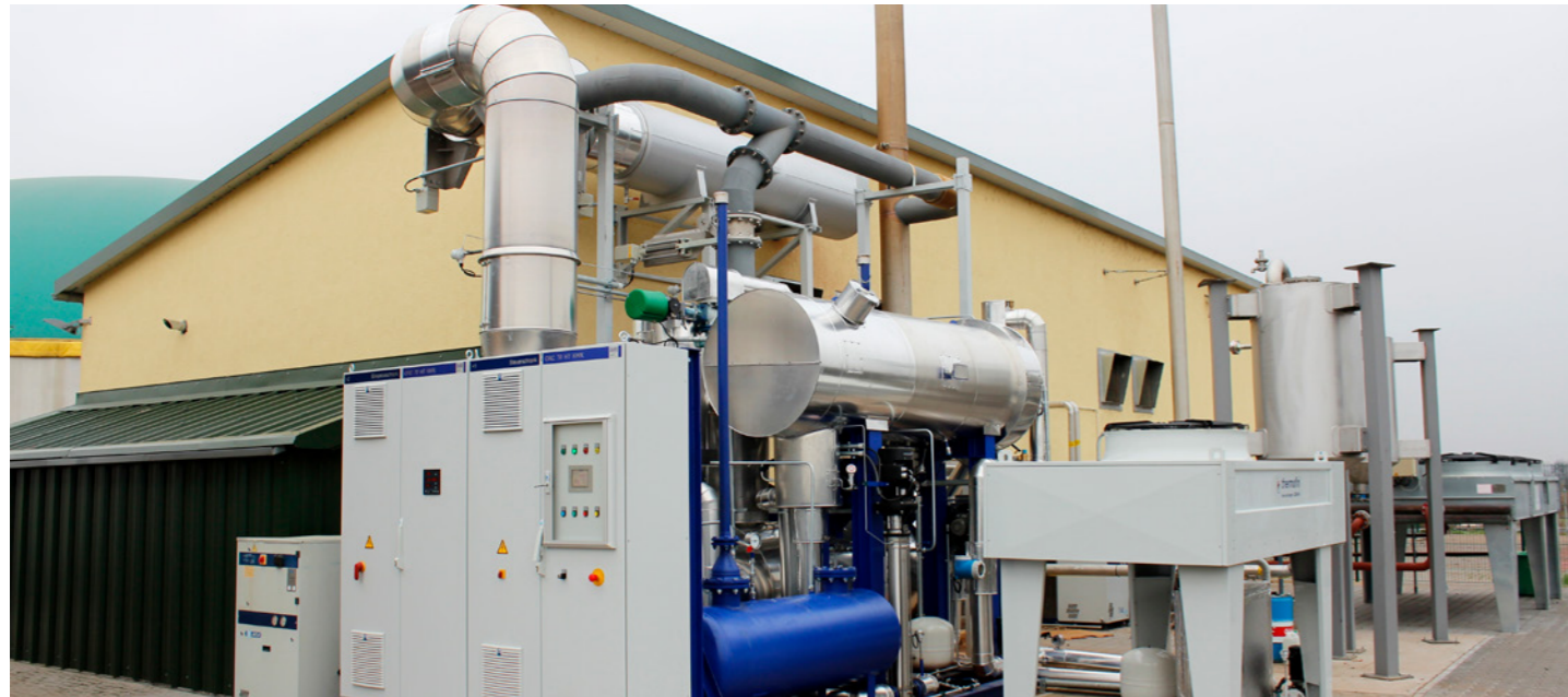
ORC-Anlage (70 kW elektrisch, von Dürr Cyplan) zur Nutzung der Abgaswärme eines Biogas-Blockheizkraftwerks.
